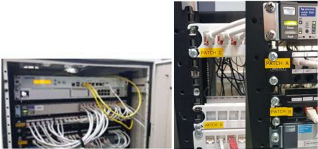
Cablaggio presso CSB
